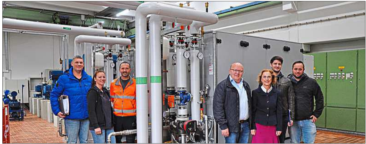
Die zwei neuen Blockheizkraftwerke sind kleiner, aber effektiver als die Vorgängermodelle. An dem Sanierungsprojekt beteiligt waren (v.l.) Christian Deger (städtisches Bauamt), Anja Raithmeier (Firma Elektro Raithmeier), Klärwerks-Leiter Reiner Köckeis, Planer Reinhold Schiefeneder, Bürgermeisterin Ilse Oswald, Wassilij Wojczenko (Firma Schiefeneder) und Tobias Kufner (Haustechnik Gruber). – Foto: Frisch
